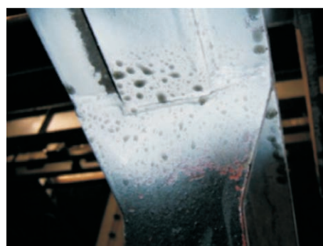
a 转向架焊缝裂纹 [7]
