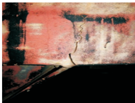
c 转向架主纵梁贯穿裂纹 [7]
